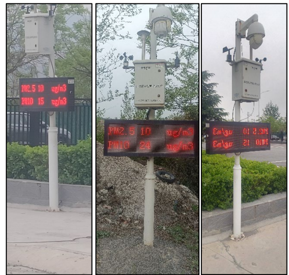
3 台在线扬尘监测系统
