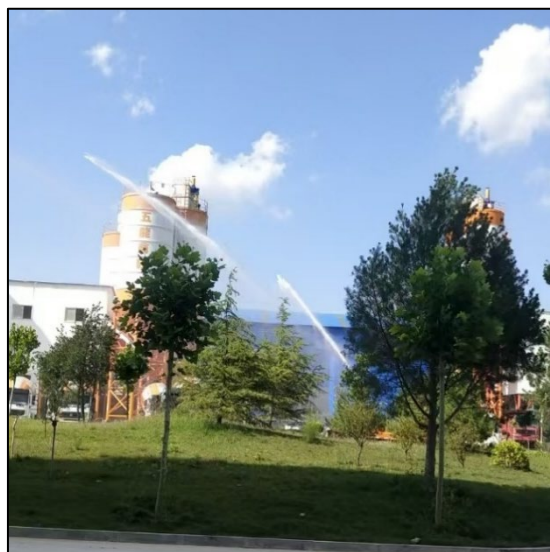
厂区 2 台高压旋转雾炮装置
