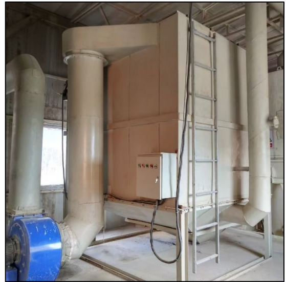
1#、2#平皮带跌落部位除尘器
