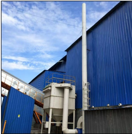
1#、2#斜皮带跌落部位除尘器
