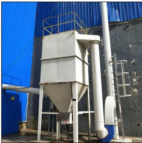
3#平皮带跌落部位除尘器
